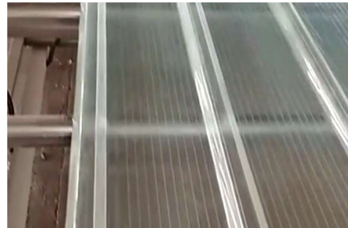
Protuberancias o hundimientos
