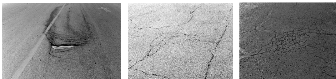
Fig. 5. Tipos de «sufrimiento de pavimentos asfaltados»
