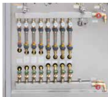
Enfriamiento mediante distribución de agua
