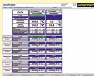
Vista general de la instalación
